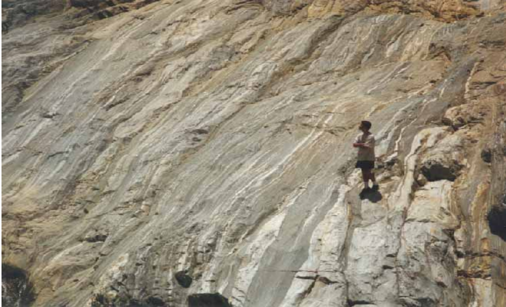
11. Macizo rocoso que conforma una ladera del río San Julián (esquina inferior izquierda), en el que se pueden destacar las discontinuidades de la roca.
