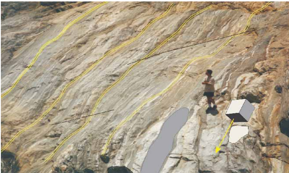
12. Mecanismo de falla en el macizo rocoso de las laderas del río San Julián. Se han presentado las discontinuidades del macizo: en negro y blanco el sistema de diaclasas y en gris (plano) o amarillo la foliación. Estos planos definen bloques que se desprenden y deslizan: el talud falla. Algunos de estos bloques alcanzarán el cauce, otros se mantendrán en la ladera formando suelos coluviales y más tarde podrían alcanzar el cauce.
